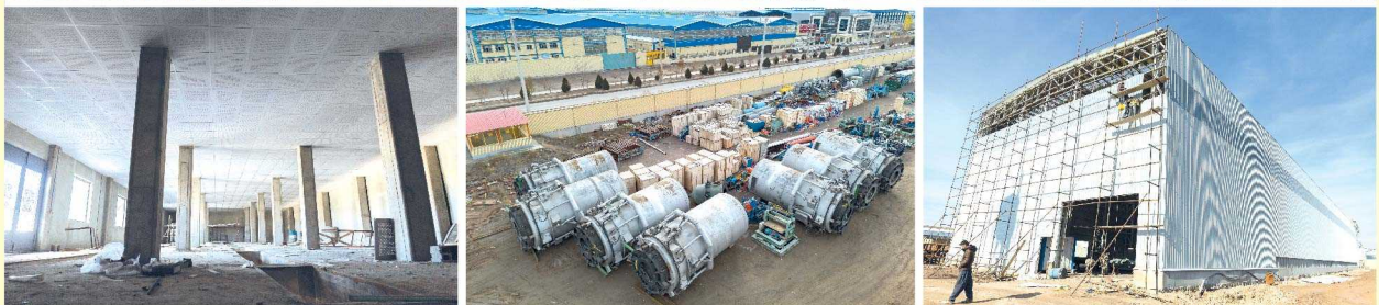
ادامه عملیات احداث کارخانجات نورد سرد شرکت صنایع فولاد شهریار تبریز وابسته به گروه صنعتی پارس ساختار
